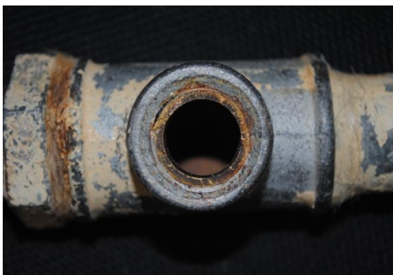
Рисунок 2 - Труба, внутри которой часть оторванного ниппеля
