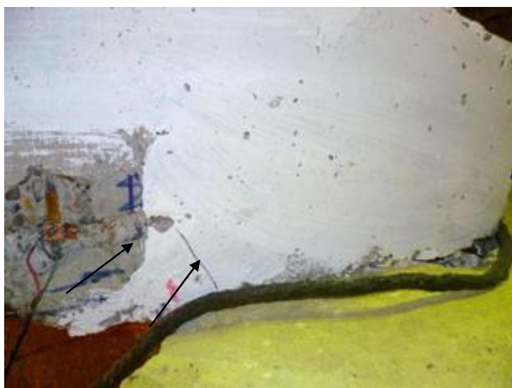
Рис.4. Образование трещин в опорной зоне
