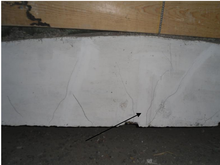
Рис.5. Образование и развитие трещин в середине пролета контурных ребер
