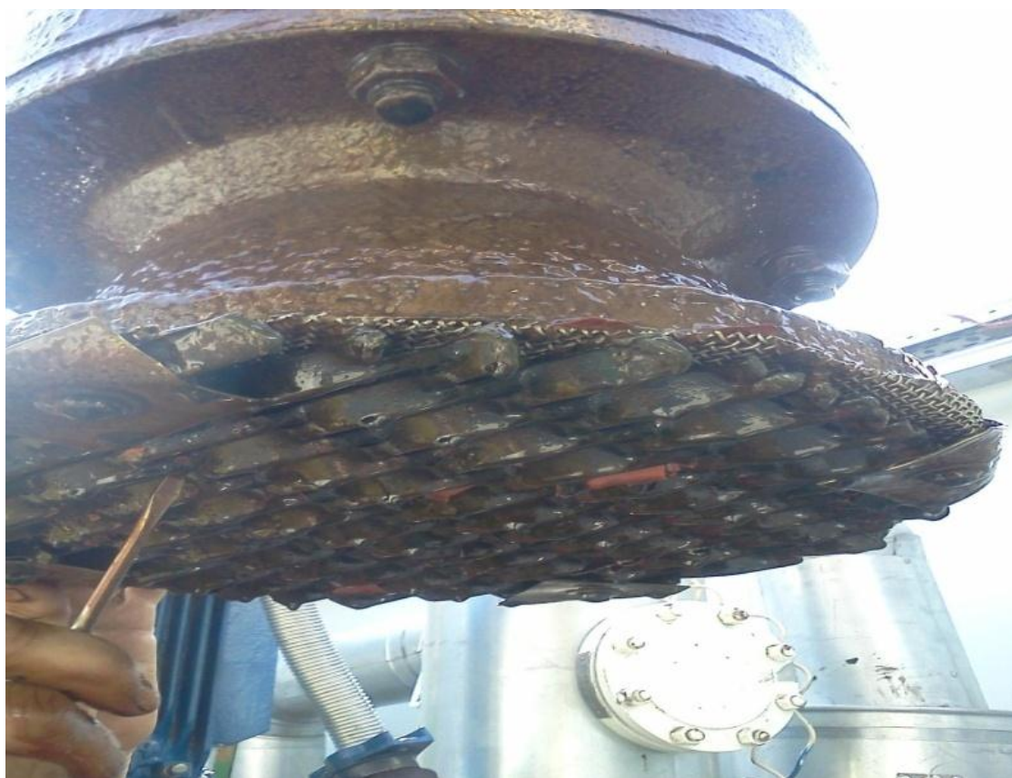
Рис. 2. Фильтр дренажной емкости с двухступенчатым фильтрующим элементом.
